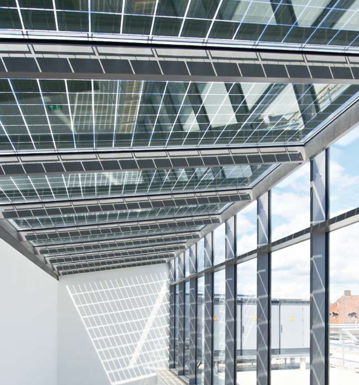
「 」 Erneuerbare Energien bevorzugt: Die Photovoltaikanlage auf dem Dach hat eine Leistung von über einem Megawatt.
